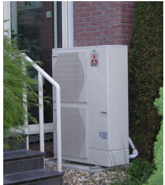
Buitenunit elektrische warmtepomp.
